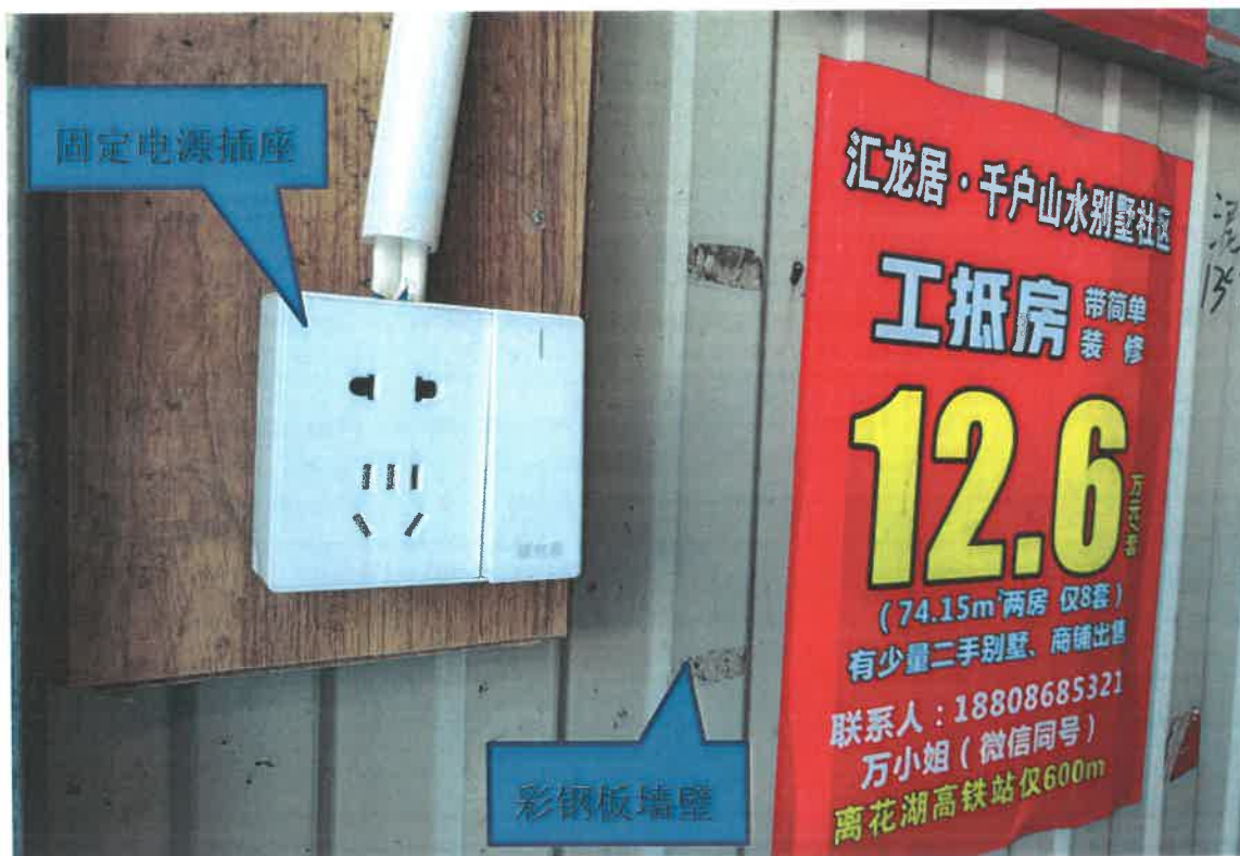
事故现场照片七：固定电源插座安装状况
